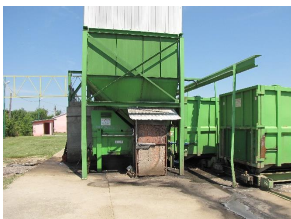
Figura: Stația de transfer Videle Sursa: PJGD
